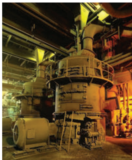
Snímek z útrob elektrárny
