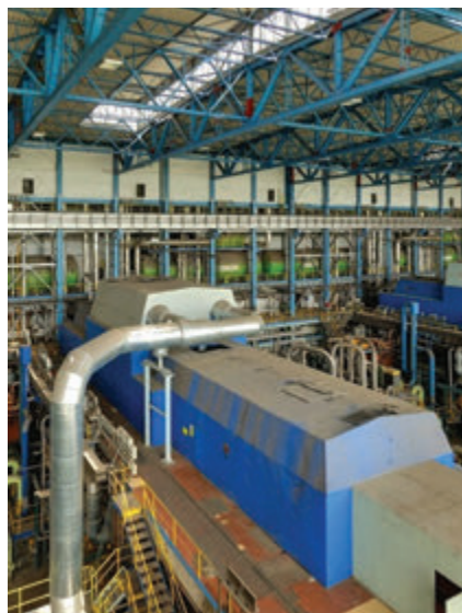
Pohled na část strojovny Elektrárny Dětmarovice
