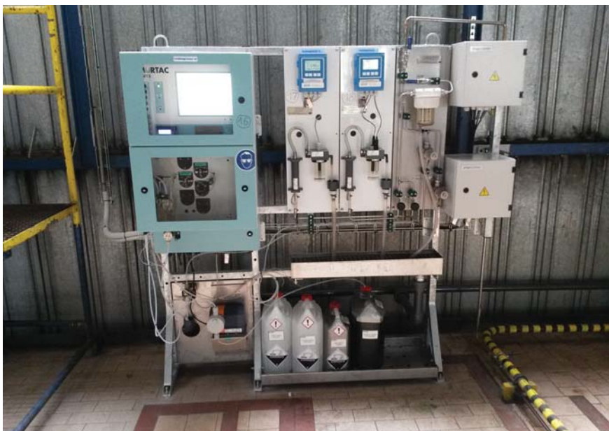
Instalace SWAS v Sokolovské uhelné (pohled do teplárny, SWAS na PPC a měření chloridů)
