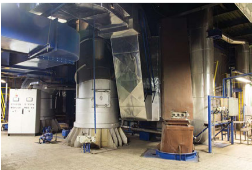
Kotel K4 má po modernizaci nové tlakové celky
