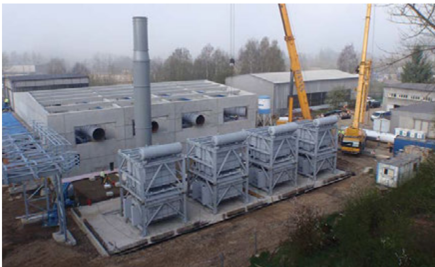
Pohled na strojovnu motorogenerátoru přes spalínové kotle
