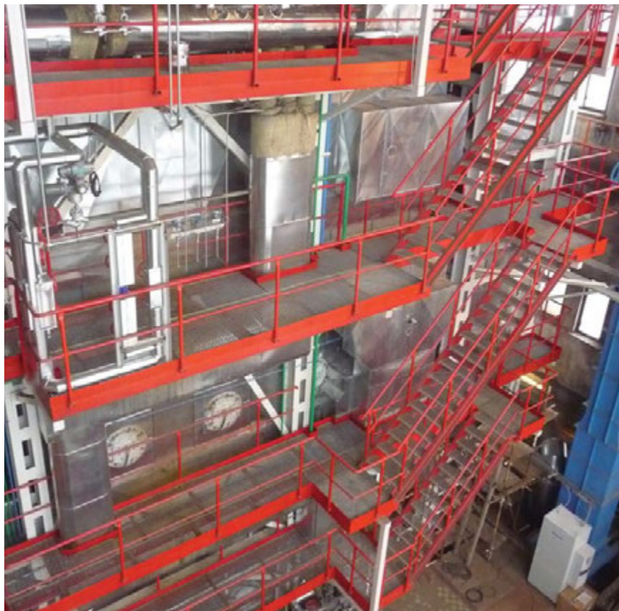
Pohled na kotel K5
