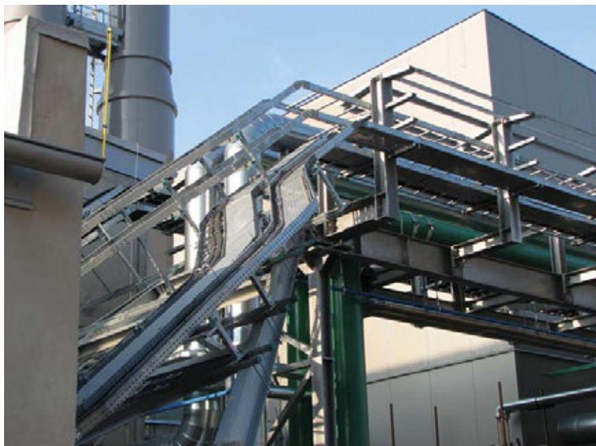
Kabelové trasy po mostech
