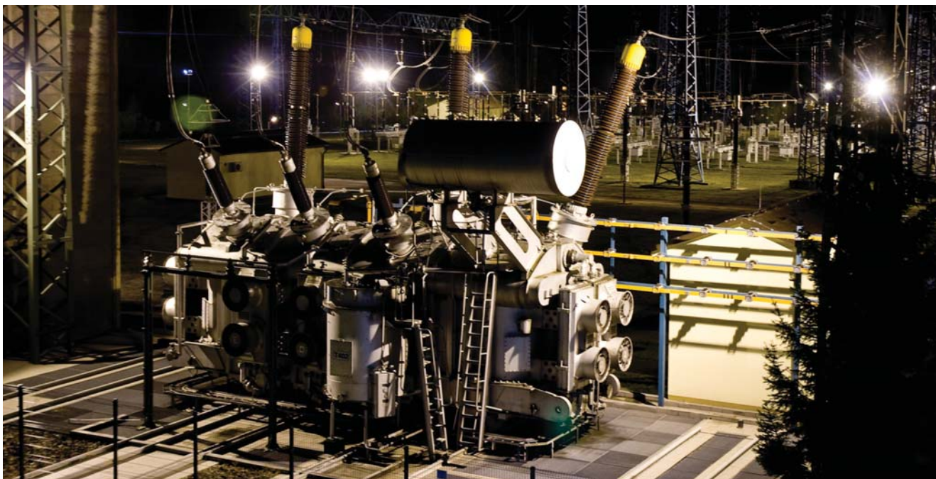
Pohled na rozvodnu - ilustrační foto
