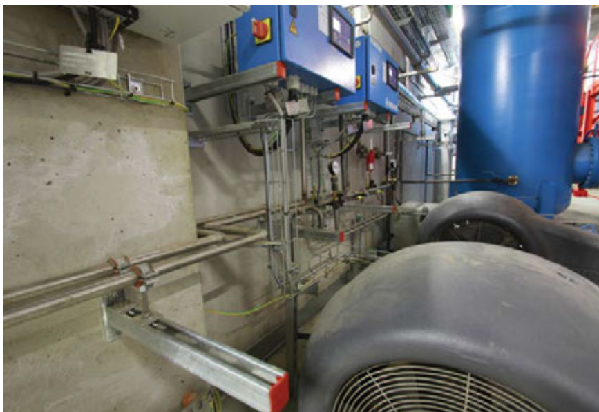
Pohled na uložení startovacího vzduchu a ovládacích skříněk, systém MQ
