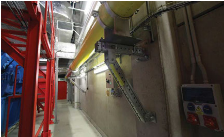
Pohled na uložení plynu DN400
