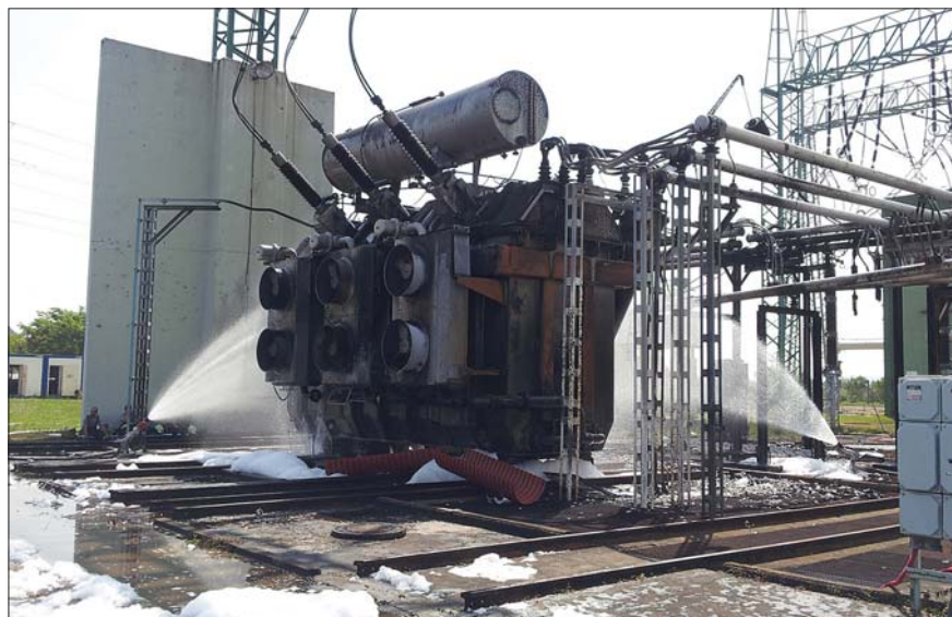
Ohořelé torzo transformátoru z rozvodny ČEPS, a. s., v Praze na Chodově. Požár způsobil přerušení dodávky elektřiny asi ve třetině hlavního města
