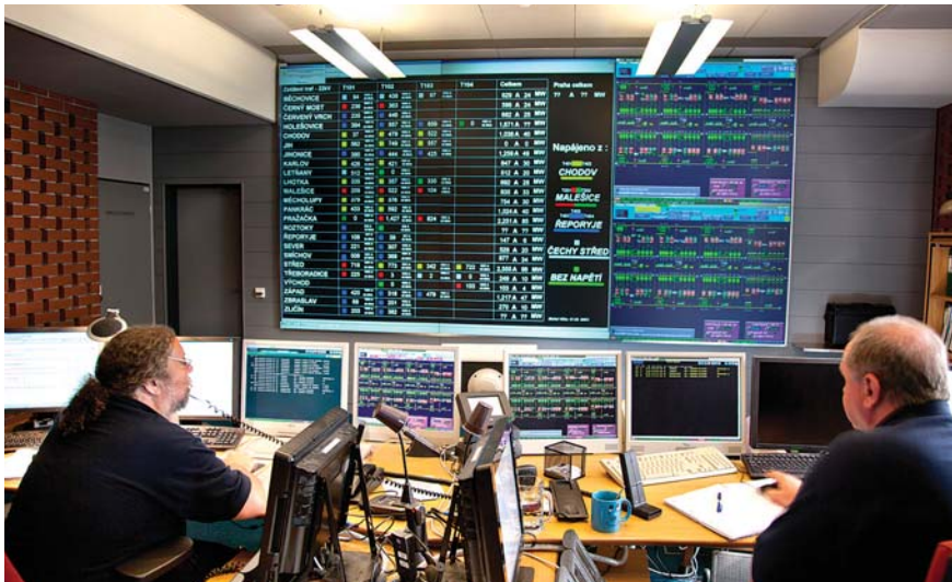
Řídicí pracoviště dispečinku PREdistribuce je energetickým mozkem hlavního města Prahy
