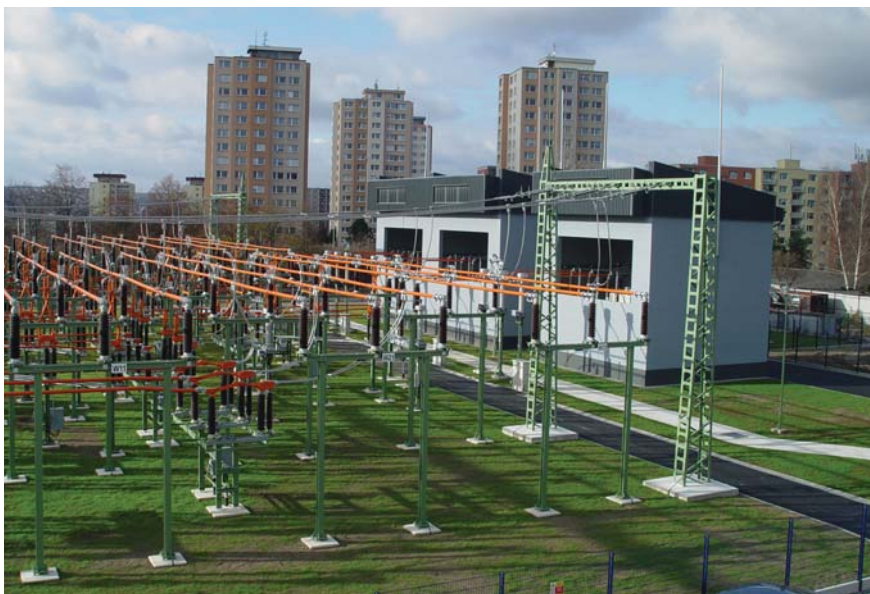
Rozvodna v Praze na Lhotce je jedním z uzlových bodů energetické sítě v hlavním městě a leží přímo v městské zástavbě
