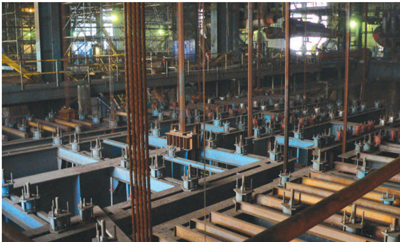
Obr. 2 – Konstrukce kotle zavěšená na lanových závěsech
