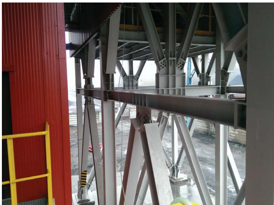
Pohled na OK (úroveň 3) pod filtr a na potrubní mosty
