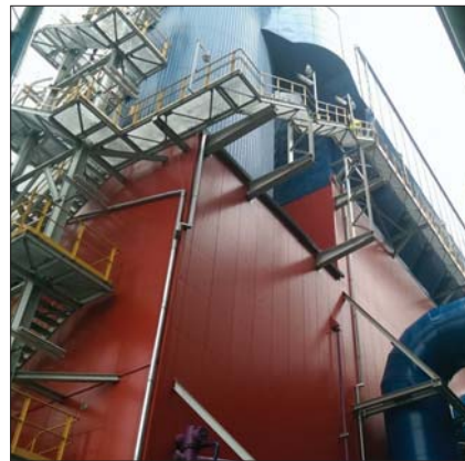
OK schodišťové věže s pohledem na absorber
