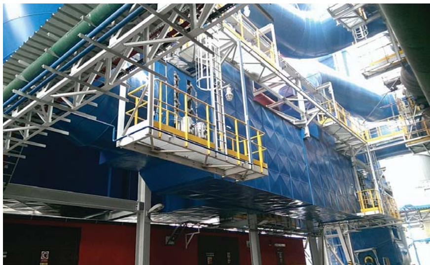
Pohled na OK (úroveň 3) pod filtr a na potrubní mosty
