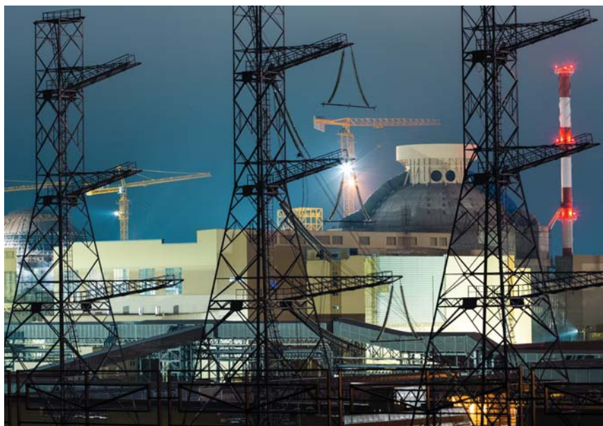
První blok Novovoronežské JE II, na němž je dobře vidět koncová část systému pro pasivní odvod tepla z aktivní zóny
