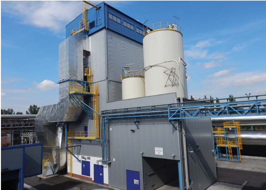
Pohled na odvod odsířených spalin čtvercovým kouřovodem (vlevo), pohled na zásobníky CaO a produktu po odsíření
