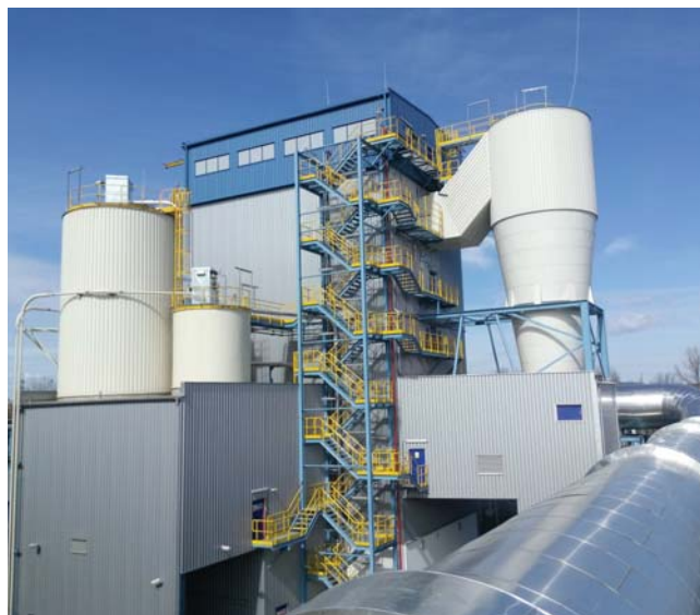
Celkový pohled na odsiřovací jednotku (zásobník PPR, zásobník Ca(OH) 2 a reaktor)
