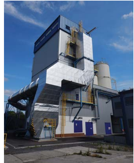
Pohled na odsířovací jednotku - v popředí odvod spalin čtvercovým kouřovodem, vpravo spalinový ventilátor
