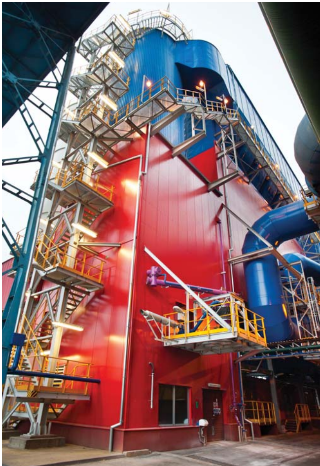
Objekt odsíření kotlů v Teplárně Karviná
