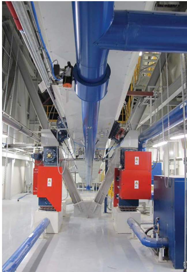
Pohled na část technologie odsíření
