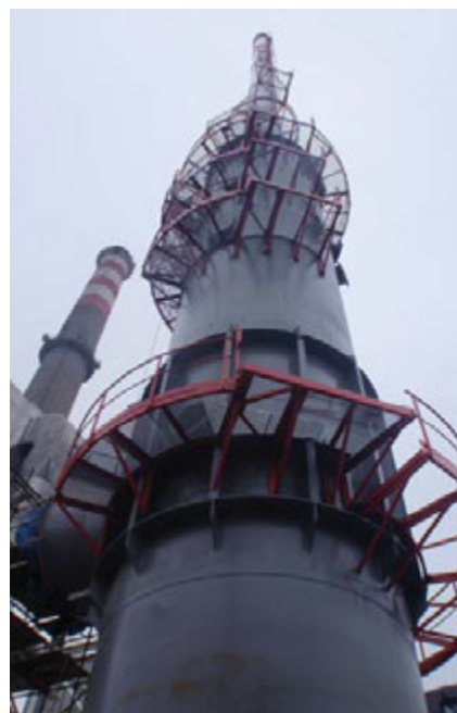
Odsiřovací absorběr s komínovým nástavcem
