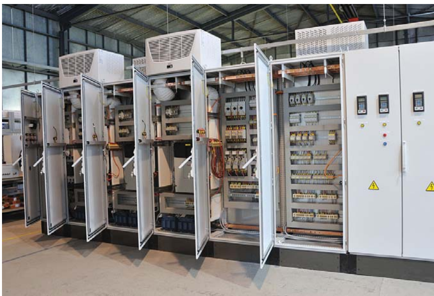
Teplná elektrárna Mariel (Kuba) - Dodávka VN a NN rozváděčů včetně ochran, rozváděčů řídicího systému, nastavení ochran, supervize a oživení
