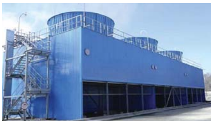
FANS (chladící věže) - opakované dodávky systémů kontroly a řízení a Měření a regulace, rozváděčů a elektročásti pro chladící věže
