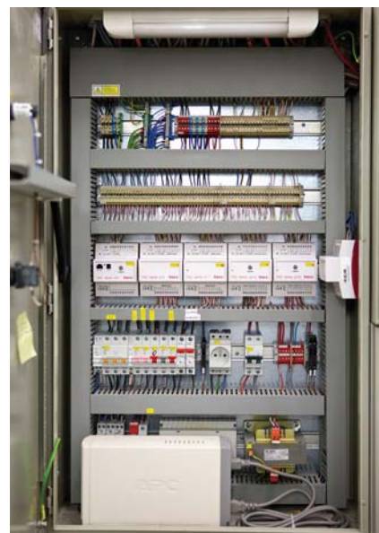
Explora, administrativní centrum v Praze - Komplexní řešení silnoproudé elektrotechnologie, slaboproudých systémů měření a regulace v moderním kancelářském projektu třídy A.
