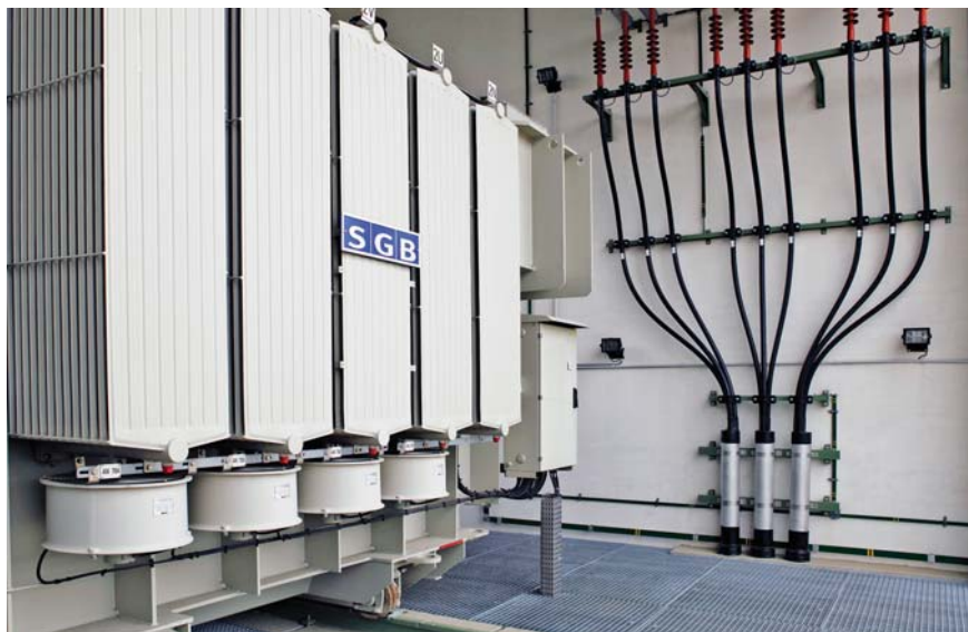
Rozvodna Ostasov TR 110/22kV (Liberec) - Stavební a montážní práce elektro pro rozšíření rozvodny s použitím moderní technologie výrazně snižující potřebu volného místa
