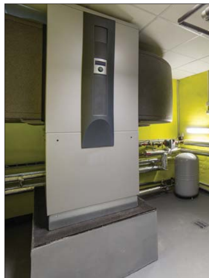
Technologie tepelného čerpadla umístěná v panelovém domě
