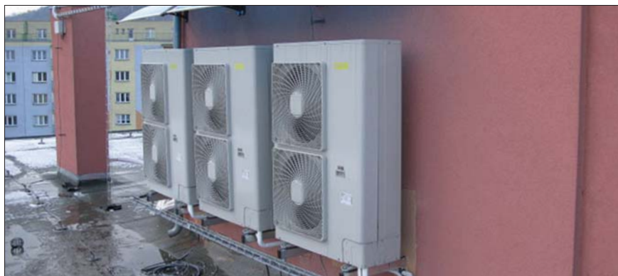
Nasávání vzduchu pro tepelné čerpadlo
