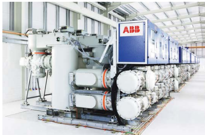
Plyněm izolovaný rozváděč 110kV
