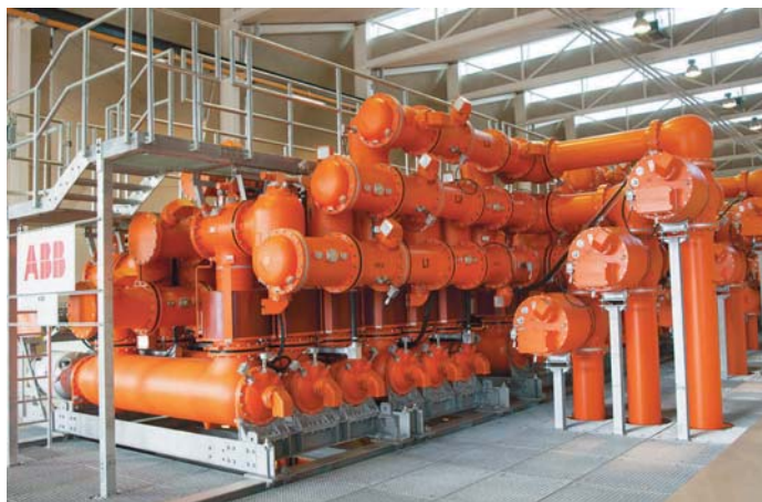
Plyněm izolovaný rozváděč 420kV
