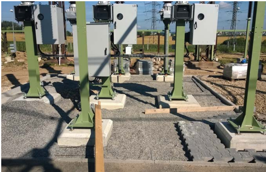
Vývodové pole před dokončením
