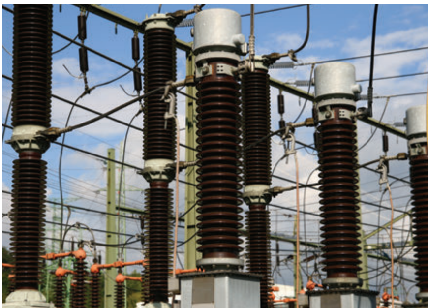
Cílem investic je zvýšení zkratové odolnosti rozvodny, navýšení transformačního výkonu a zajištění spolehlivé vazby mezi přenosovou soustavou ČEPS a distribuční soustavou společnosti ČEZ Distribuce – ilustrační foto
