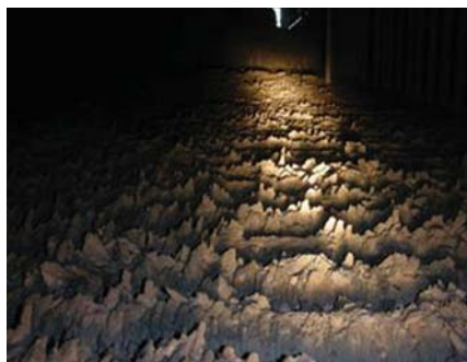
Obr. 2 - Zanesený přehřívák č. 1
