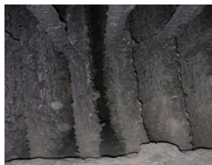
Obr. 4 - Zanesený přehřívák č. 3
