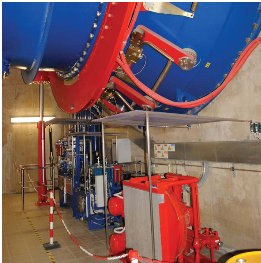
Pohled na oběžné kolo a další technologie strojovny MVE Štětí
