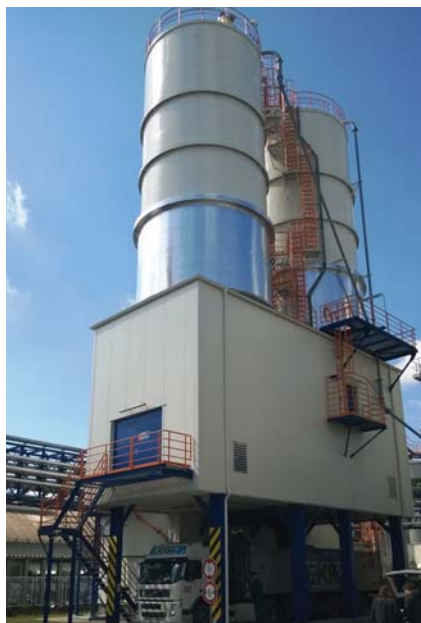
Celkový pohled na PS04 - míchací centrum
