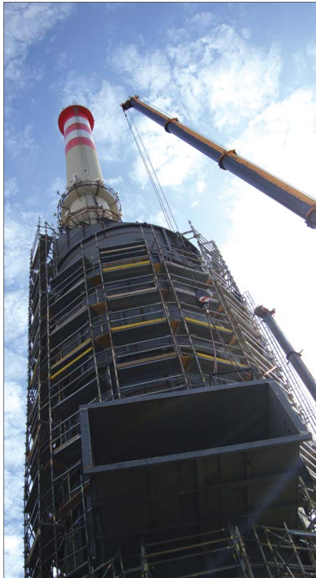
Potrubní systémy pro odsíření spalin
