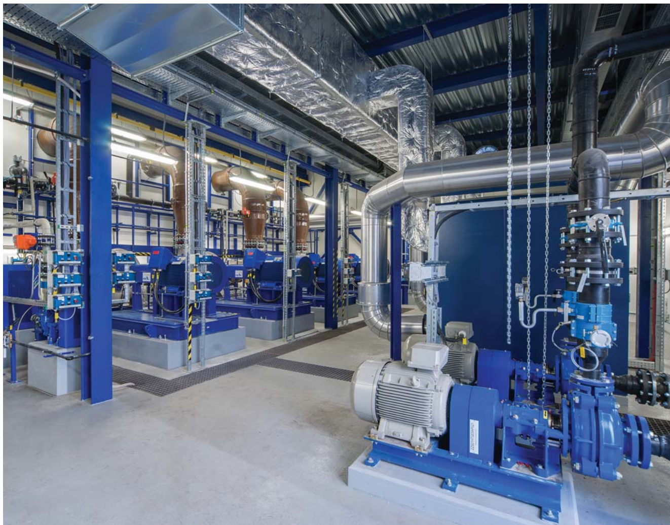
Vnitřní část budovy s recirkulačními čerpadly
