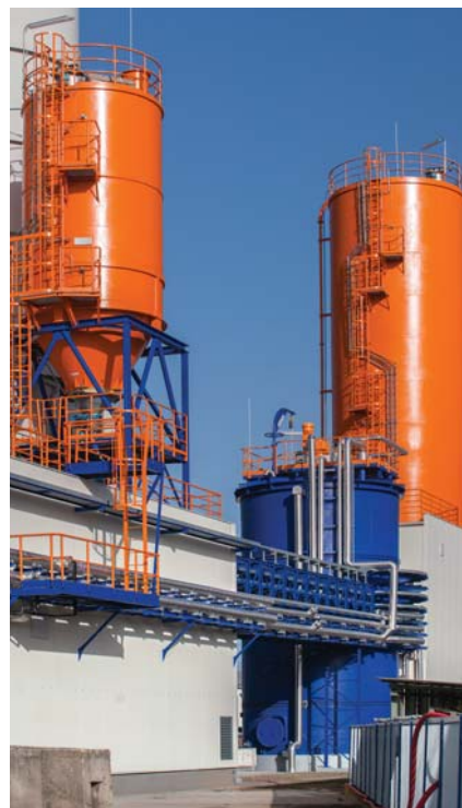
Pohled na sila popílku a nádrže pomocných provozů
