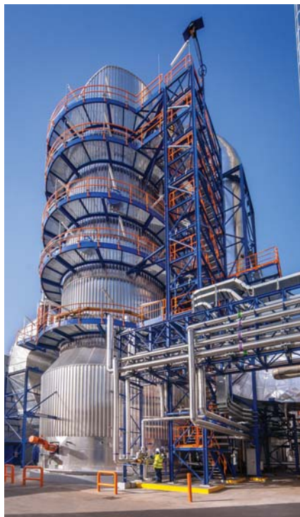
Pohled na absorbér, schodišťovou věž a potrubní most
