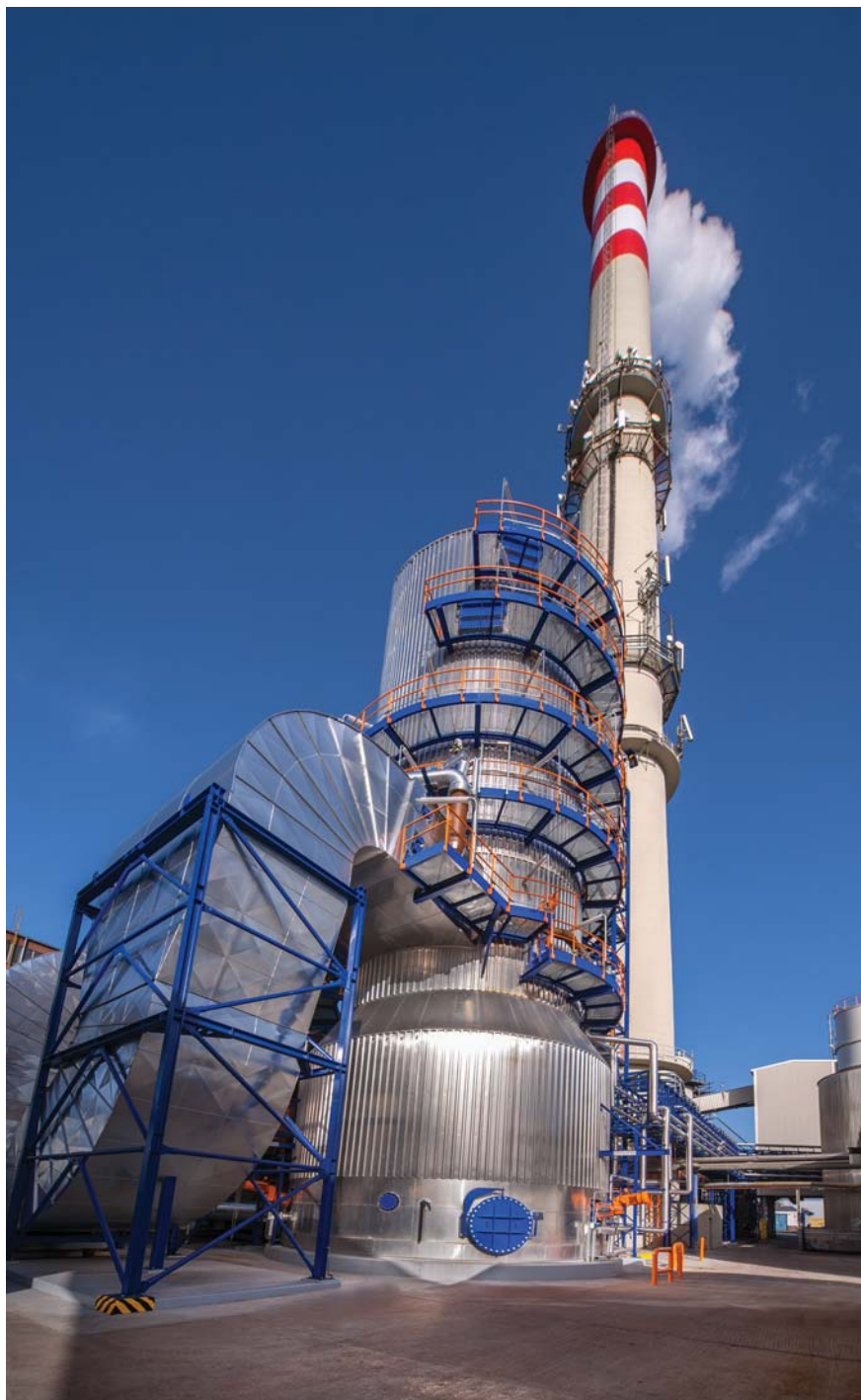
Napojení kouřovodů nevyčištěných spalin do absorbérů včetně komínu
