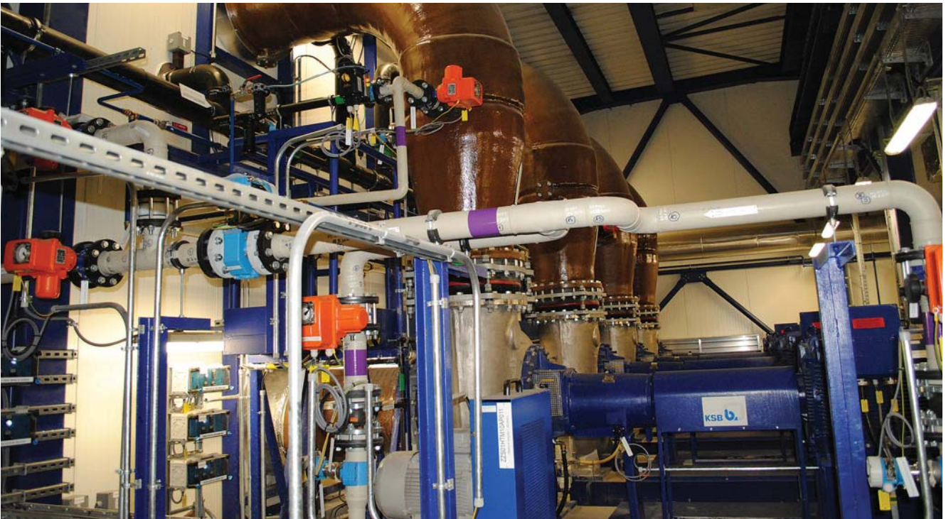
Technologie pro odsíření spalin
