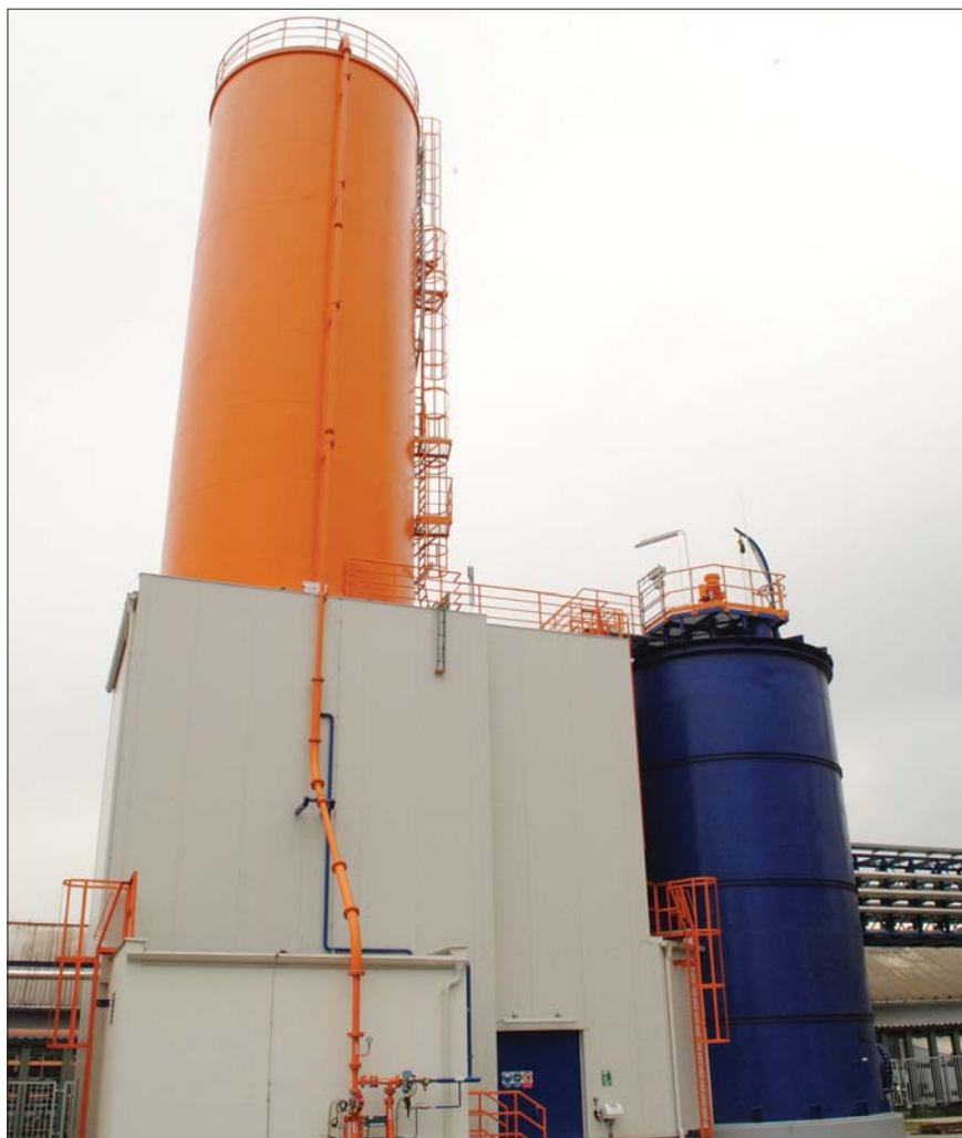
Pohled na vápencové hospodářství nového odsíření v Teplárně České Budějovice
