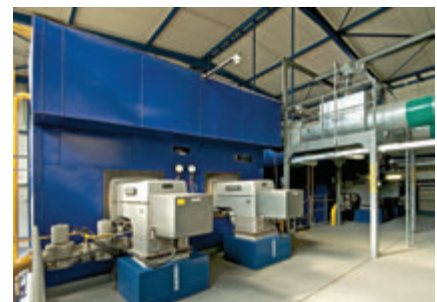
Horkovodní plynová kotelná se dvěma kotli 2 x 27 MWt
