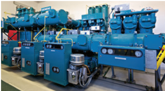
Zapouzdřená rozvodna 110 kV
