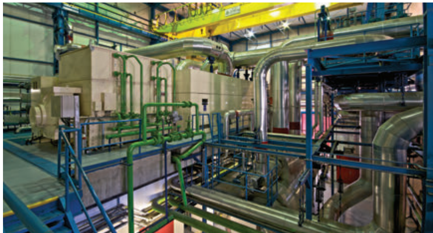
Strojovna s parní turbínou
