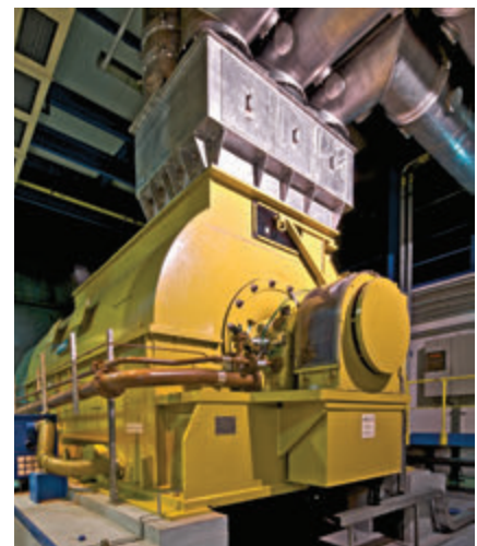
Generátor spalovací turbíny Siemens
