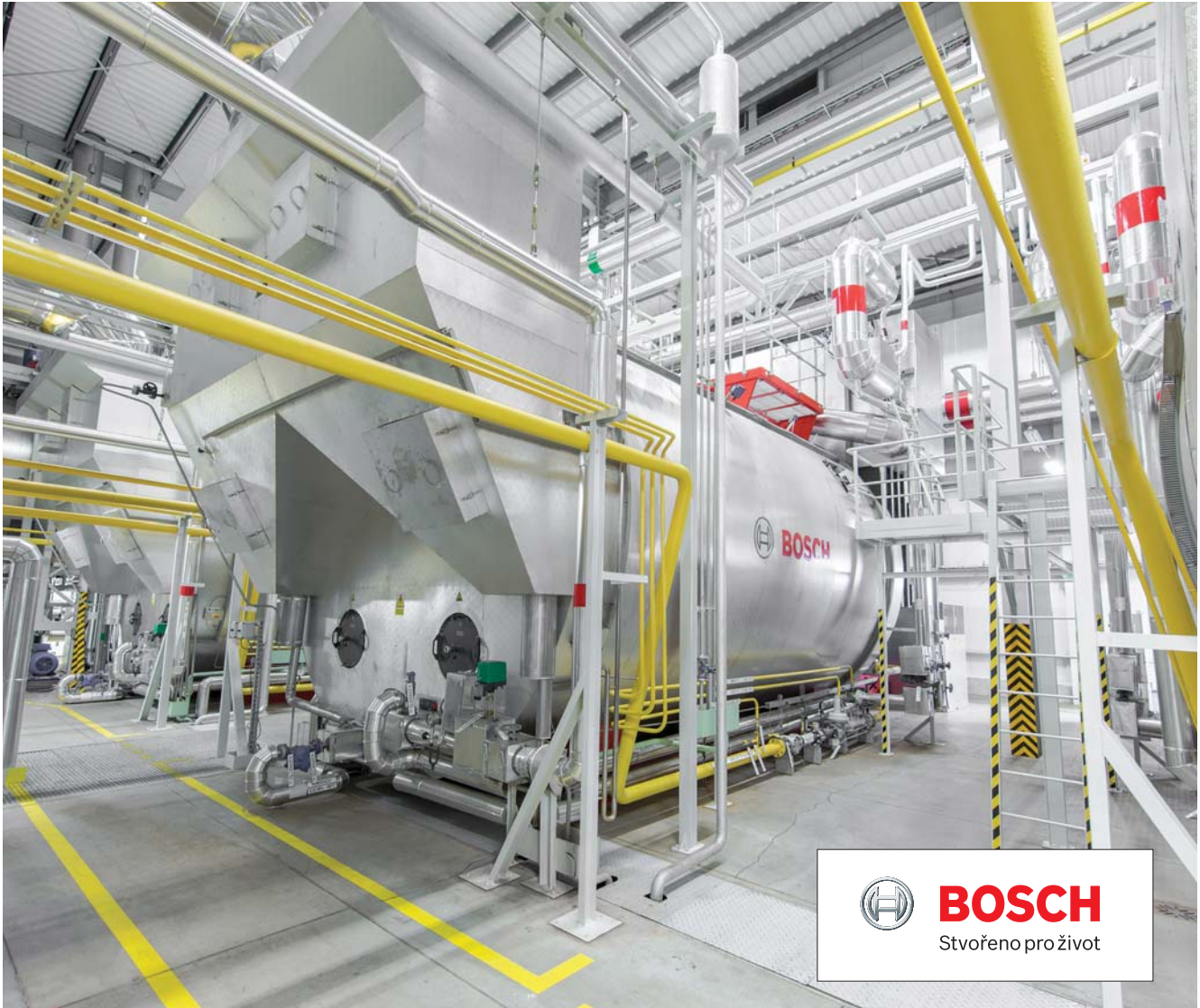
Kotelna aktuálně pracuje daleko nad předpokládanou dobou 500 hodin
