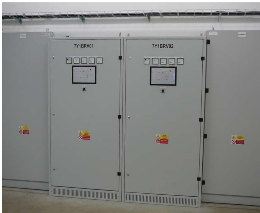
Rozvaděče zajištěného napájení. 220VDC, střídač Master, střídač Slave, 400VAC
