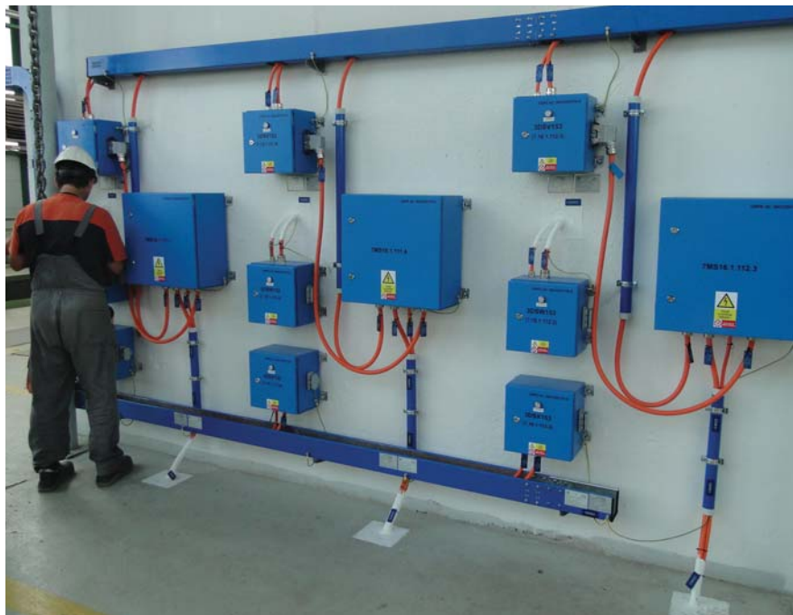
Přechodové DSV a zásuvkové skříně
