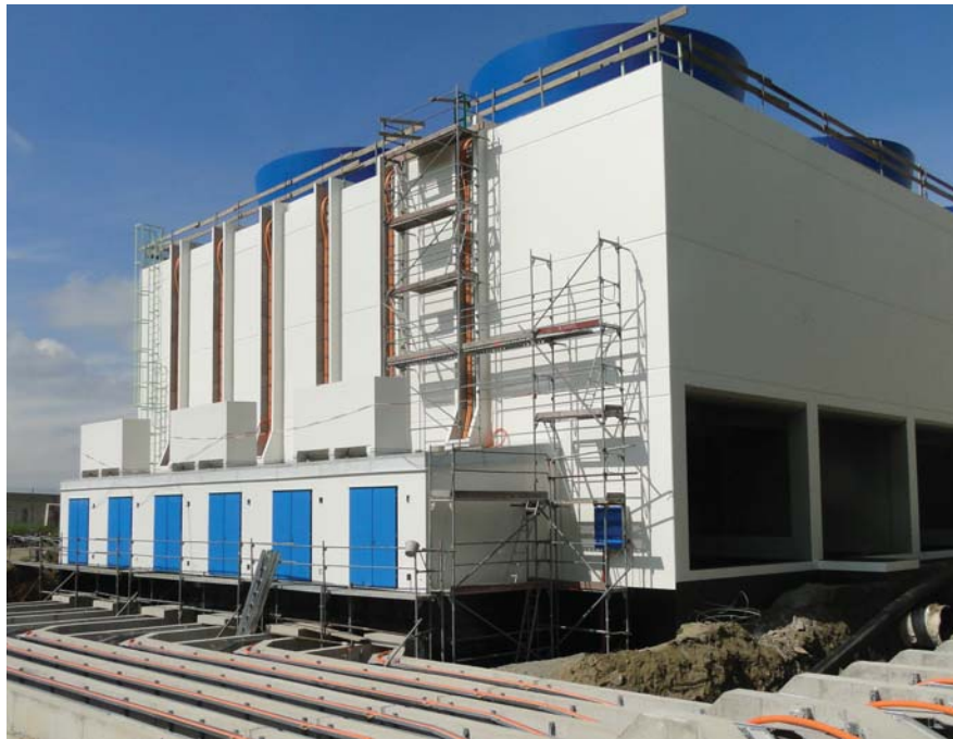
Celkový pohled na venkovní kabelové kanály u koncového jímáče tepla a vysokonapětové kabely
