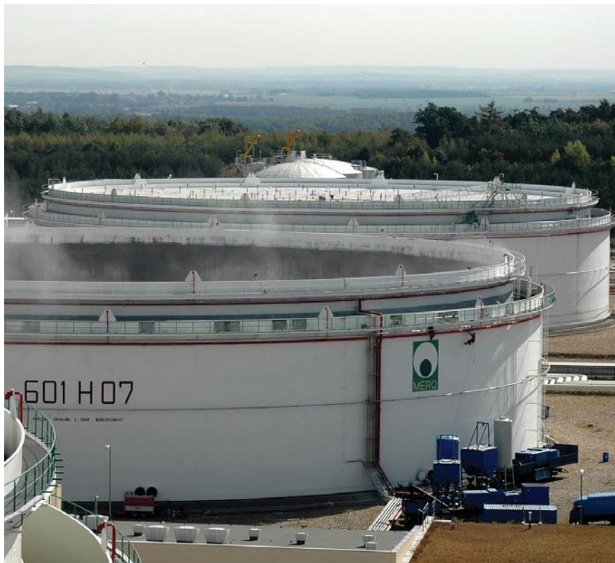
Skladovací nádrže pohonných hmot
