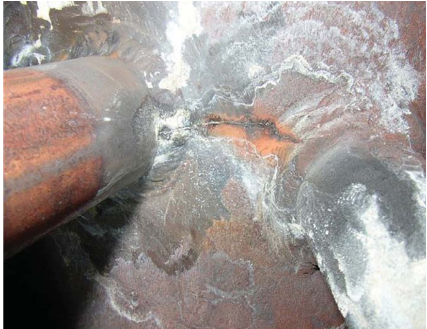
Obr. 1.1 – Příklad výskytu trhlin na komoře
