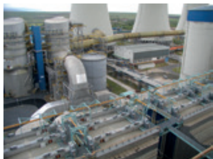
Przewody spalinowe odsiarczenia zostały odprowadzone do jednej z wież chłodniczych
