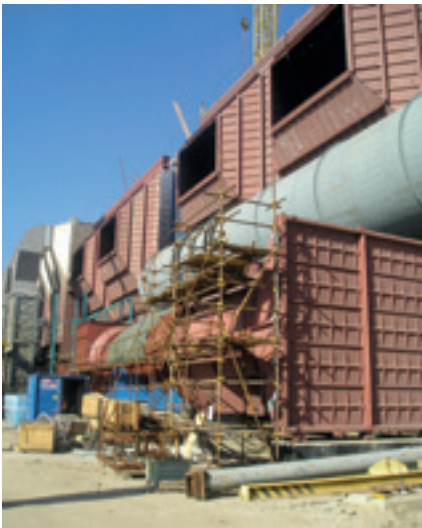
☒ Część wylotowa elektrofiltrów (październik 2013)
