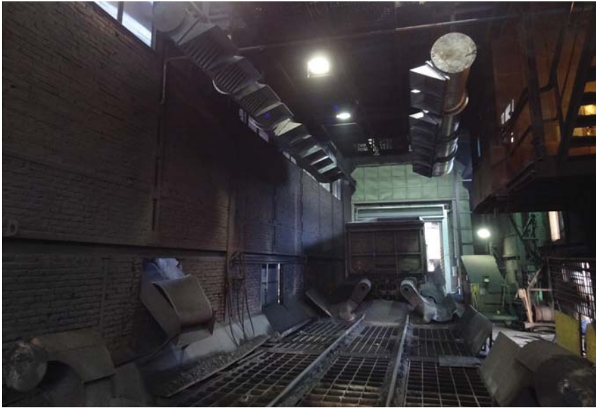
Výklopy s odsáváním
