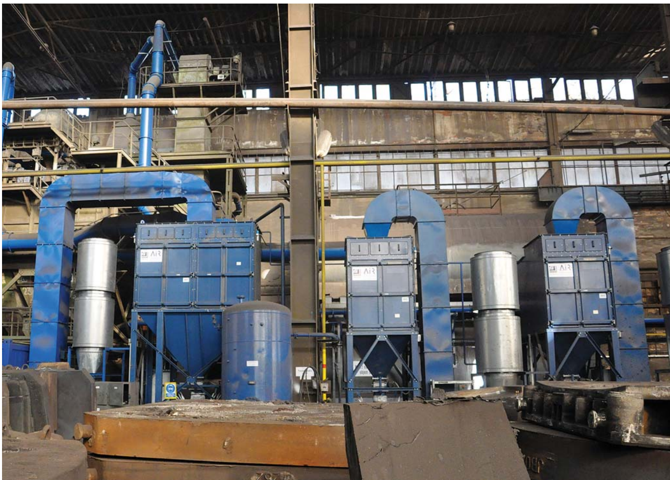
Pohled na odlučovače ve Slévárnách Třinec
