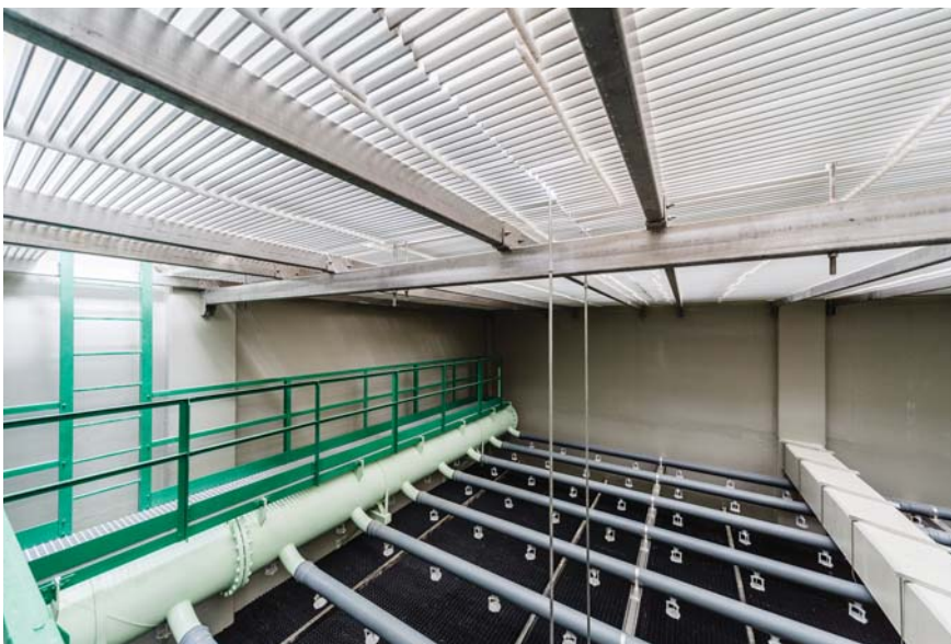
Rozvod oteplené vody v KJT
