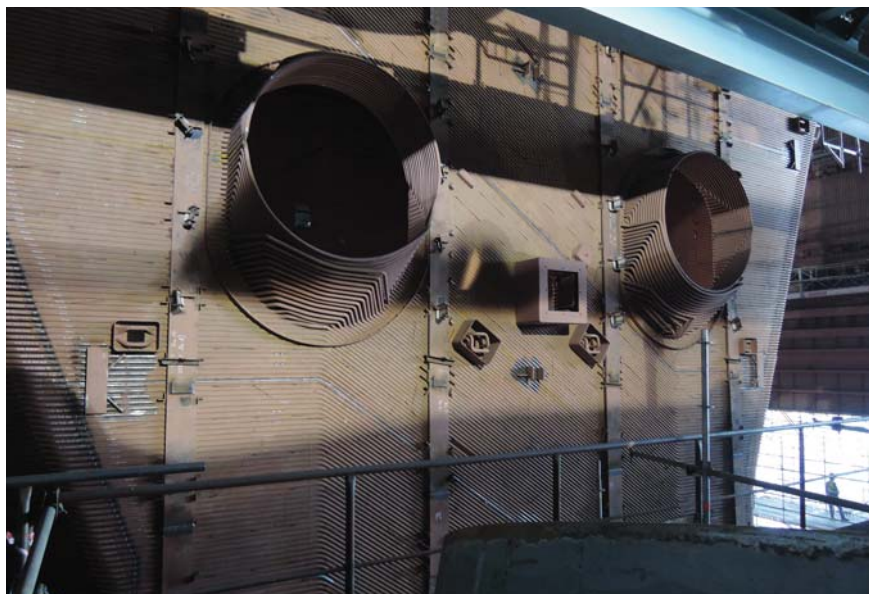
Obr. 4 – Šikmý přechod trubek MeS boční stěny výparníku v oblasti sušek
