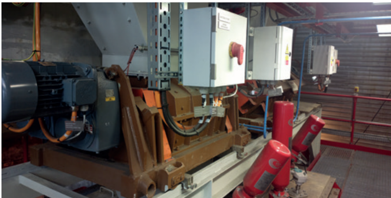
❏ Oprócz kruszenia węgla rozdrabnia się również żużel piecowy (Elektrociepłownia Skawina) i popiół z łoża – kruszarki typu DVR (foto: ciepłownia Planá, ČR – kruszarka DVR 10).
