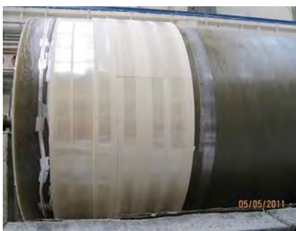
Nádrž DN3500, osazená topným kabelem (zateplená 100 mm PUR)
