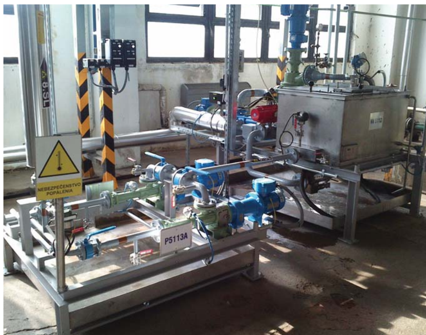
Čerpací stanice slopového oleje s macerátorem
