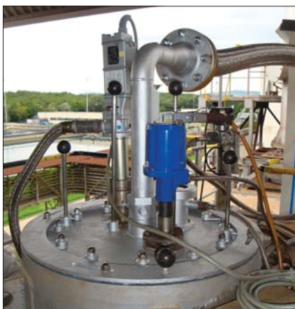
Nový plynový hořák dohořivací komory
