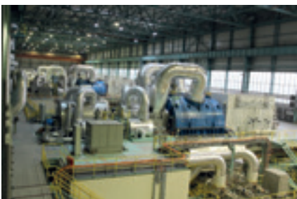
☒ Maszynownia elektrowni Tušimice 4 x 200 MW po rekonstrukcji
