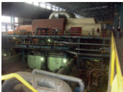
❏ Pierwotna turbina ABB Zamech w elektrowni Prunéřov
