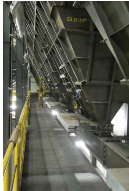
Pohled uvnitř - spodní část 20tikomorového rukávového filtru - nečistoty padají na zakrytý dopravník a jsou odváděny do síla
