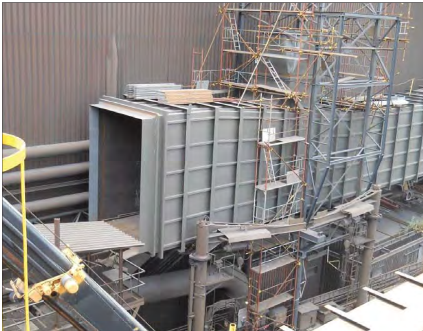
Přívodní potrubí od konvertorů
