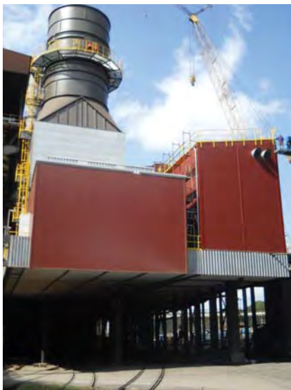
Pohled na výdechový komín
