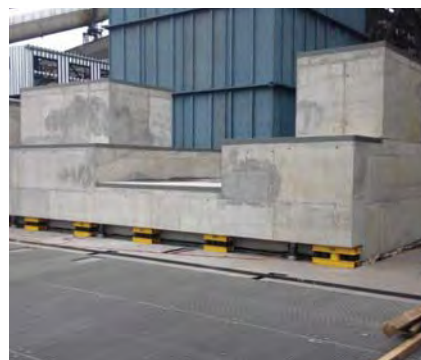
Probíhá nadzvednutí základů (300t) pro jeden z ventilátorů + jeho podložení pružinovým systémem
