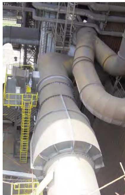
Odvod vzdušiny z úseku odsíření surového železa – v provozu
