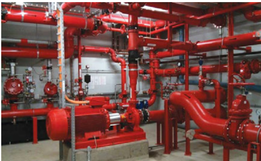
Strojovna systému vodních SHZ
