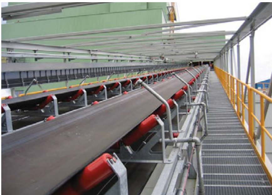
Ochrana zauhlovacích pasů
