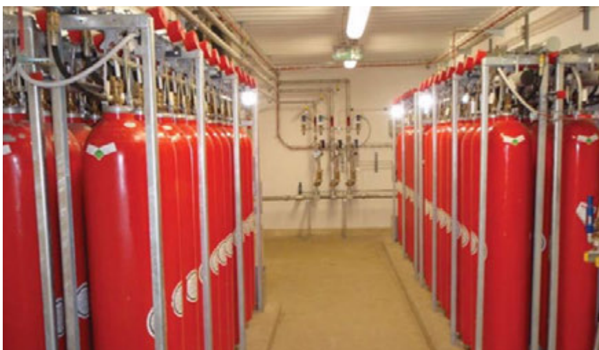
Strojovna systému na CO 2
