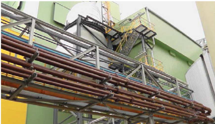
Pohled na technologická zařízení kladenské teplárny
