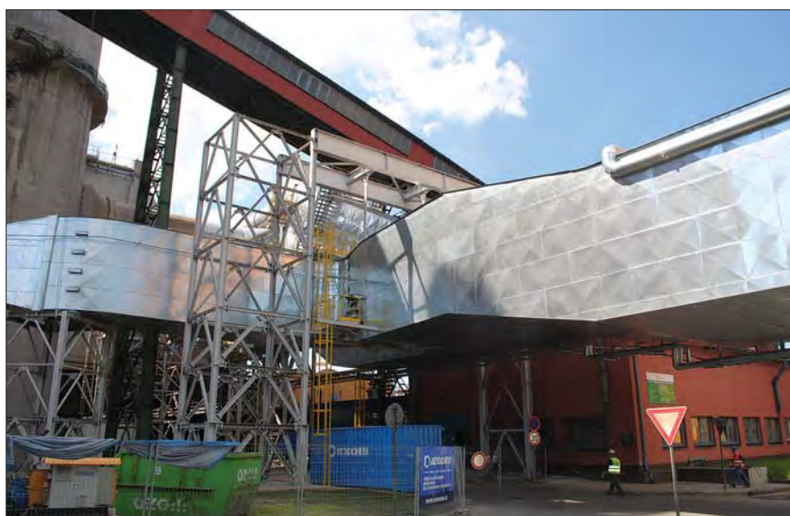
Přívod spalin od kotlů k technologii odsíření
