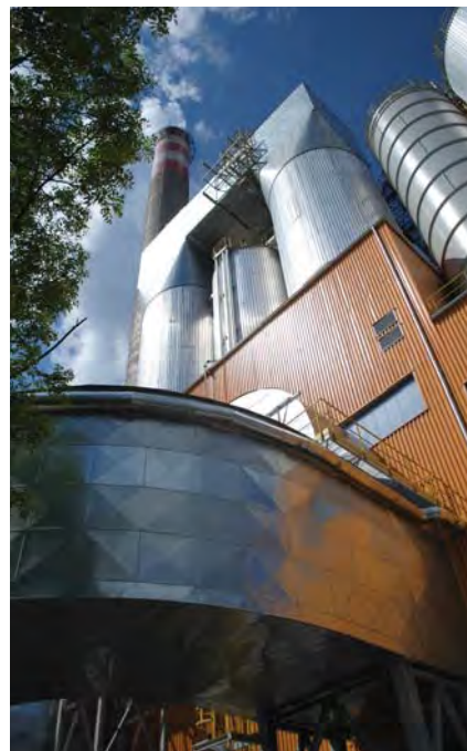
Pohled na dokončené zařízení na odsíření spalin Energetiky ArcelorMittal Ostrava
