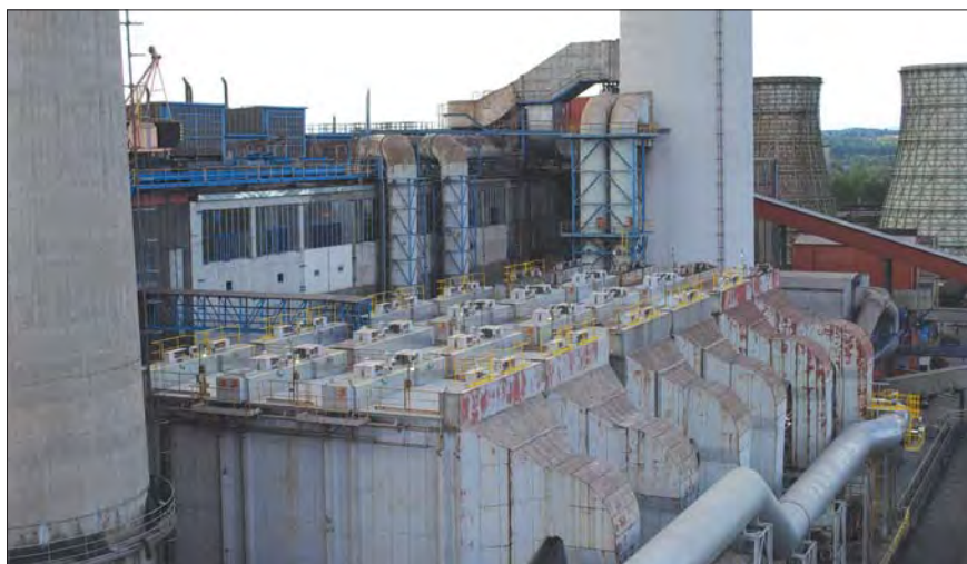
Pohled na stávající kotle
