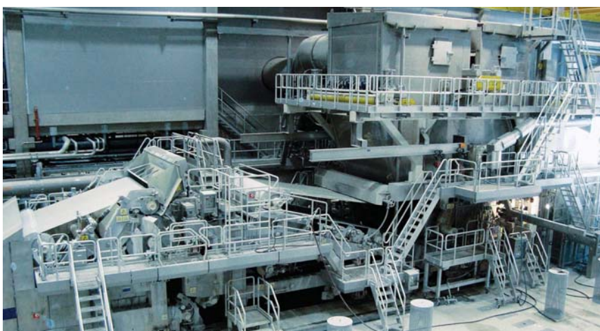
Papírenský stroj Krapkovic (Polsko) - montáž elektrotechnologie a dodávka systému měření a regulace stroje na výrobu hygienického papíru
