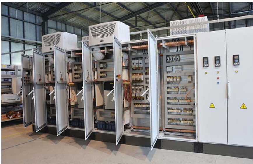
Výrobní sklářské linky Teplice - kompletní technologická elektroinstalace. Provedení rekonstrukce a výstavby všech tří linek R1, R2 i R3 na ploché sklo včetně projektu, dodávky a montáže rozvaděčů Cofely - ilustrační foto
