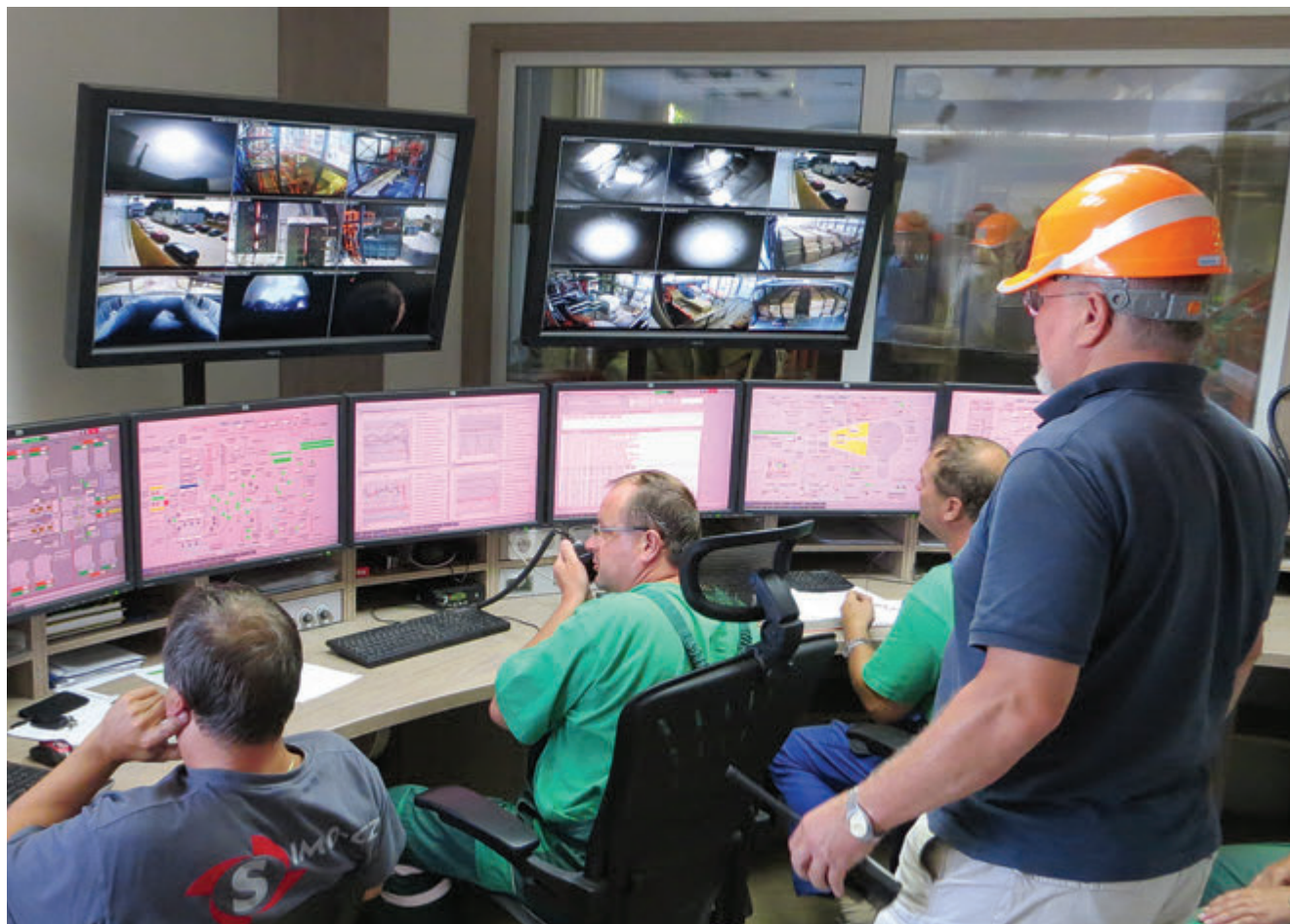
Snímek z velínu při uvádění do provozu
