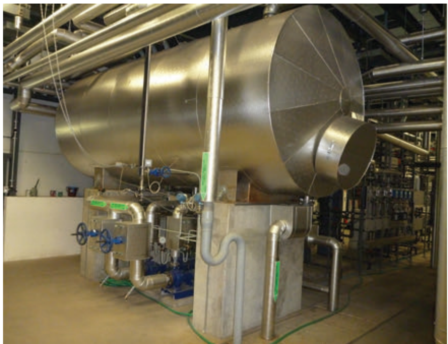
Nádrž sběrného kondenzátu
