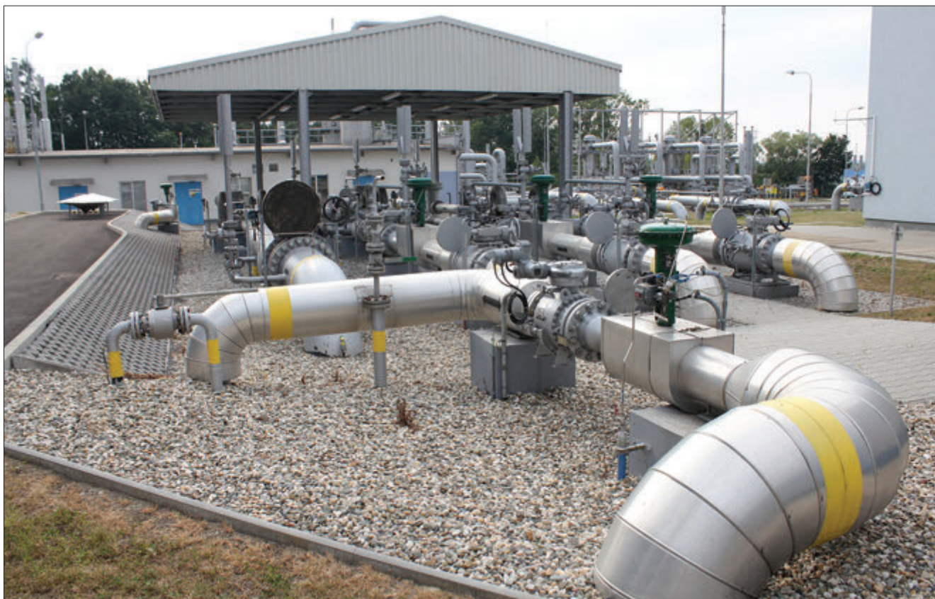
Nové obchodní měření - centrální areál podzemního zásobníku na plyn Třanovice
