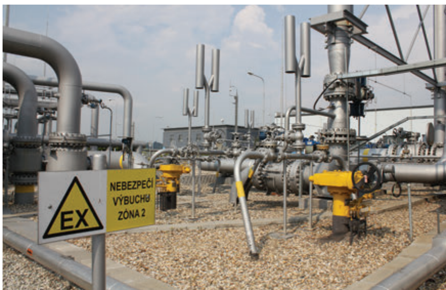
Potrubní dvůr - vstup do sušení plynu
