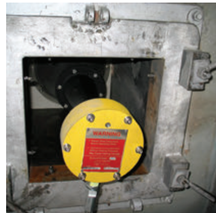
Obr. 14 - Zástavba akustického měniče na kotli PK4
