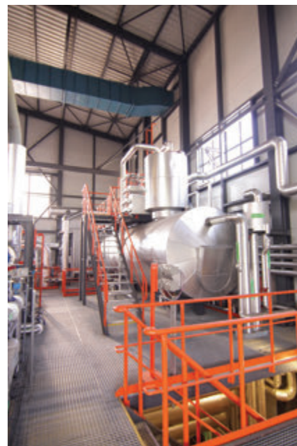
Tepelná strojovna a napájecí nádrž
