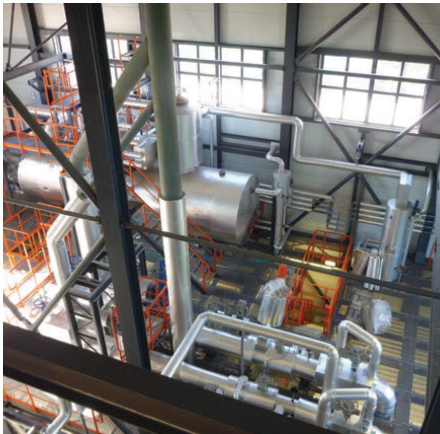
Celkový pohled na tepelnou strojovnu
