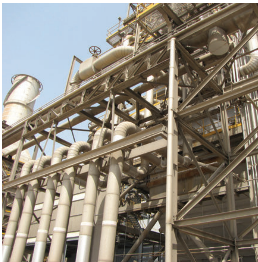
Pohled na technologická zařízení elektrárny
